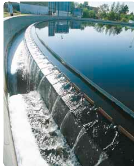
▲ Planta de tratamiento de aguas servidas.
